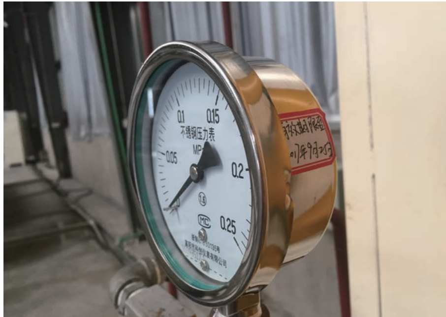
安全装置有效期检查
