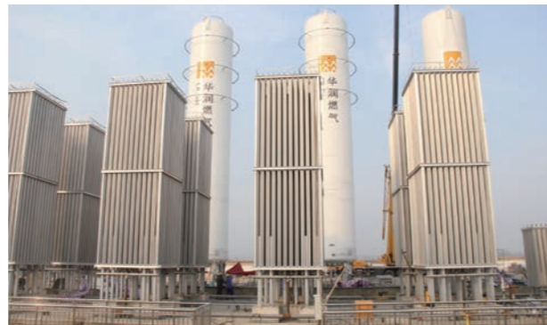
南阳茶庵建成 LNG 储备站
