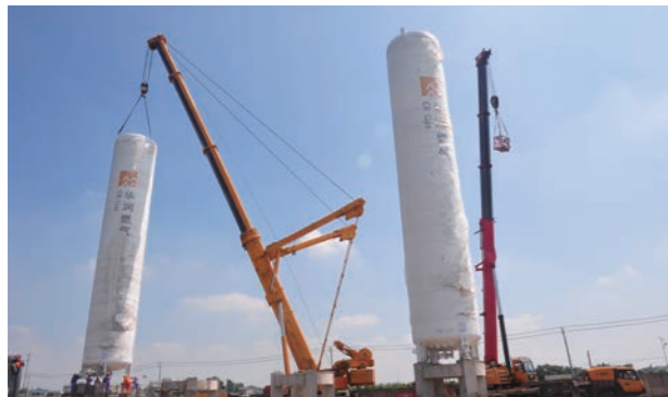
江宁公司投资建设上湖 LNG 储备站
